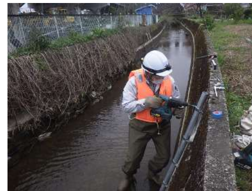
水位センサーの設置状況
