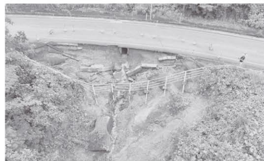
7月の豪雨により被災した際の市道第2工業団地線の様子（八尾地域）
