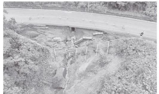
7月の豪雨により被災した際の市道第2工業団地線の様子（八尾地域）
