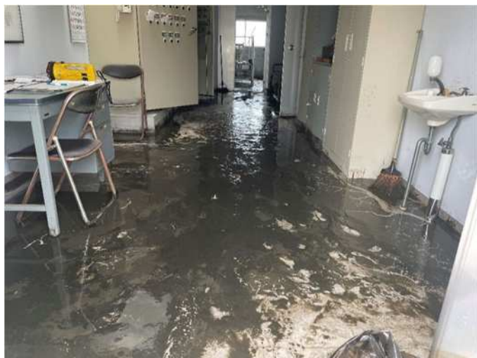
被災状況（床上浸水）
