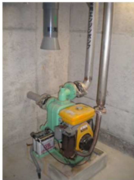
非常用エンジンポンプ
