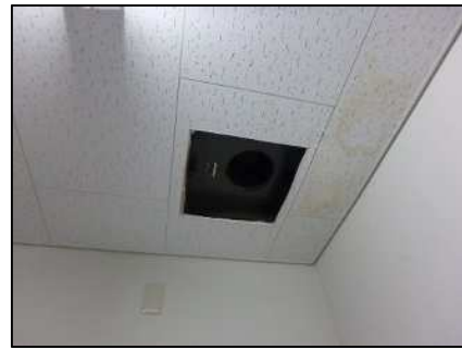
【3階視聴覚室の倉庫天井】
