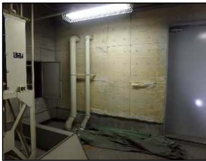
【4階電気室内の状況】
