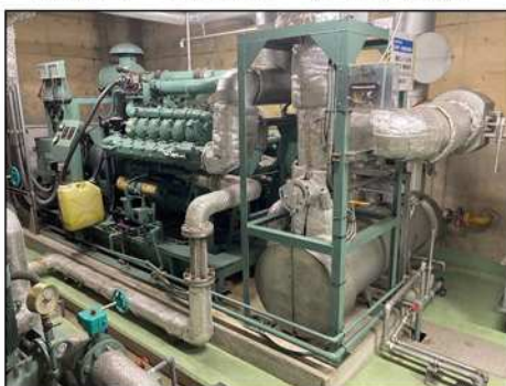
既設コージェネレーション設備
