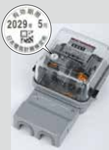
電気メーター (有効期間10年) ※一部を除く。
