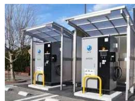
充電施設 蓄電池
