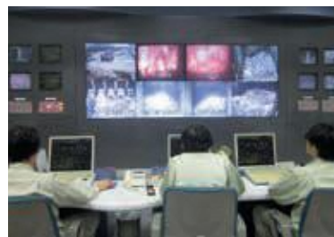
せいぎよ 中央制御室
