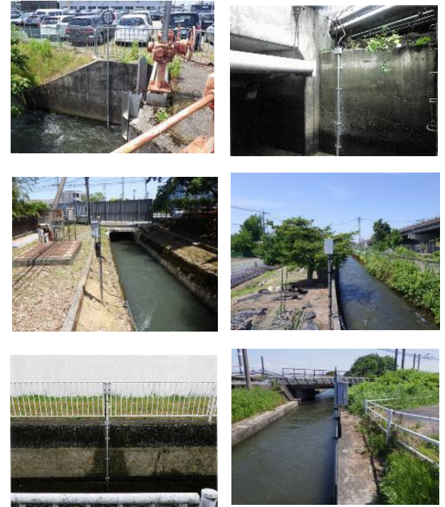
水位センサーの設置状況
