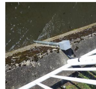
水位センサーの設置状況
