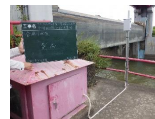
水位センサーの設置状況
