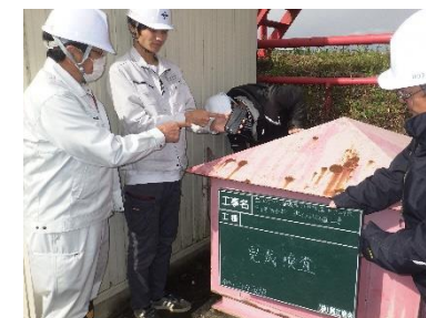
水位センサー設置状況の確認
