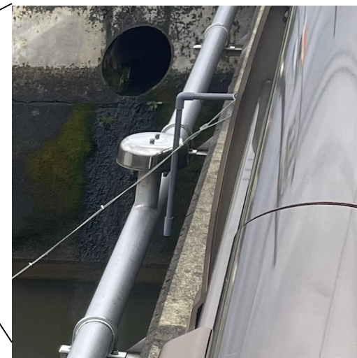
超音波水位計 周辺のパイプの影響を受けないように センサーを延長して設置
