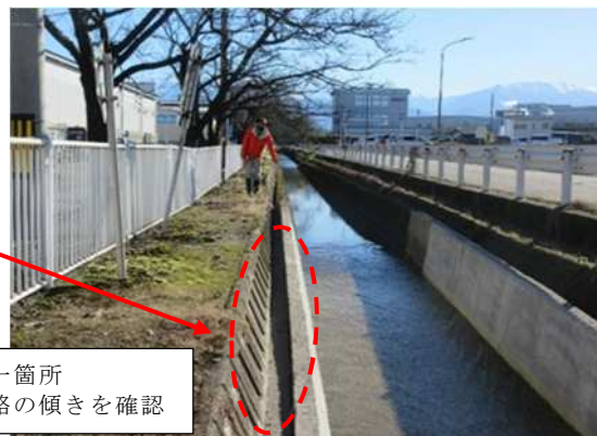
○損傷状況（被災後）
