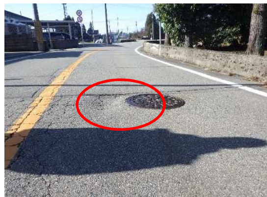
マンホール周りの沈下
