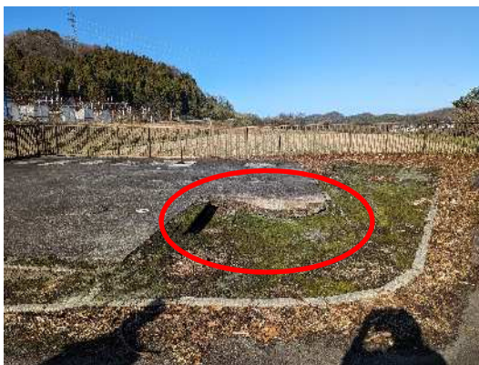
処理場敷地内の地盤沈下
