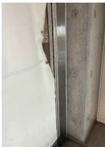
防火シート不良箇所
