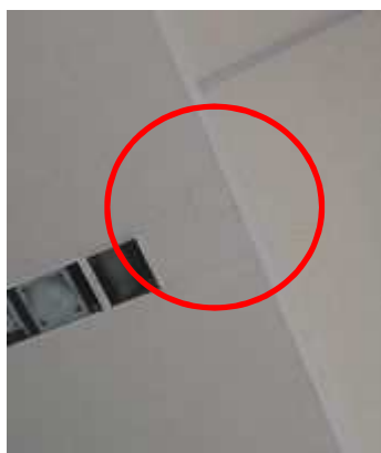
市民プール天井の損傷箇所
