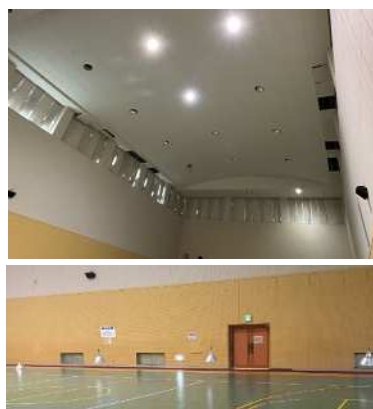
八尾スポーツアリーナサブアリーナ天井・照明器具の落下
