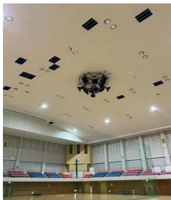
八尾スポーツアリーナメインアリーナの天井落下
