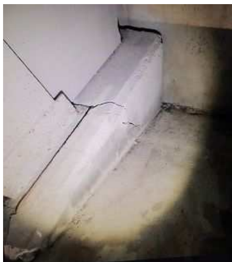
梁受け部分のひび割れ箇所
