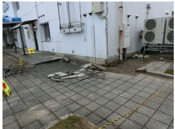
地盤沈下・隆起（本館北西角）
