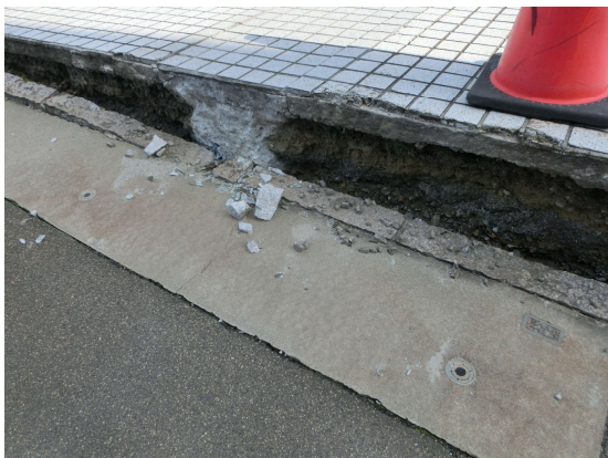
破損した消雪装置
