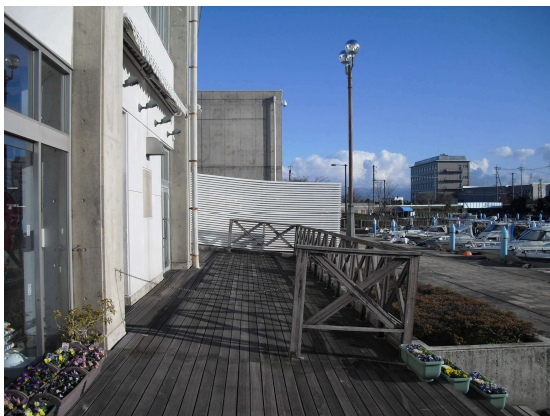
地盤沈下により傾いたウッドデッキ
