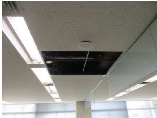
被害状況（本庁舎 内装）
