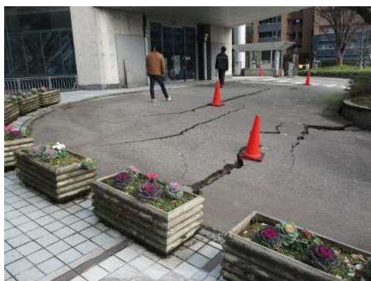
被害状況（本庁舎 外構）
