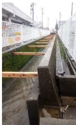
水路壁の傾斜
