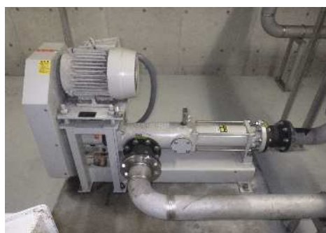
熊野月岡南部地区処理場
