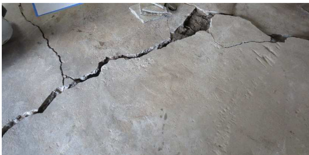
土間コンクリートのひび割れ
