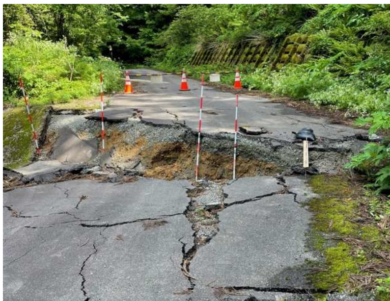
林道八尾牛岳線の被災状況
