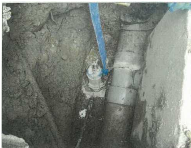
神通川アユ・マス増殖場施設：配管
