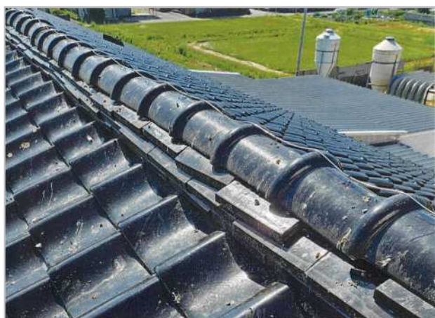
牛舎の屋根瓦のずれ
