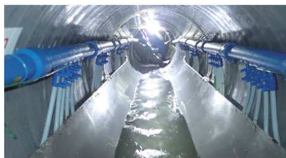
下水道管内の採熱管
