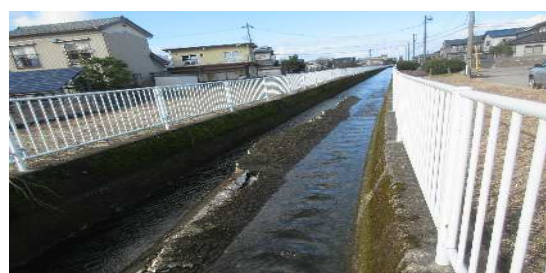
隆起により破損した農業用水路
