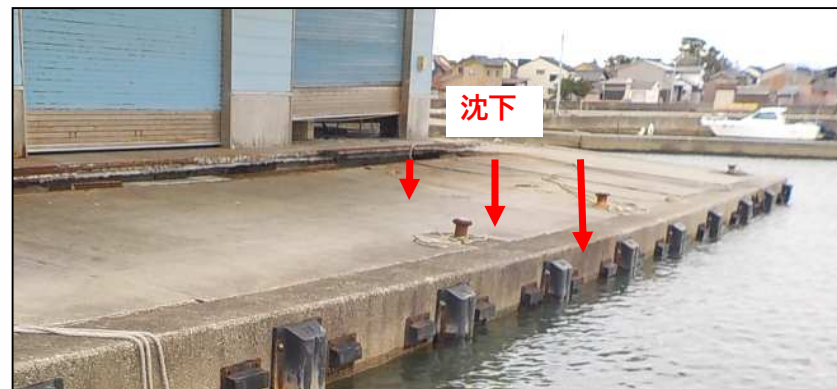
沈下により破損した漁港施設(水橋漁港)
