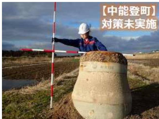
能登半島地震の被害状況
