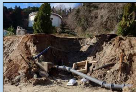
浄水場の被災状況（七尾市）
