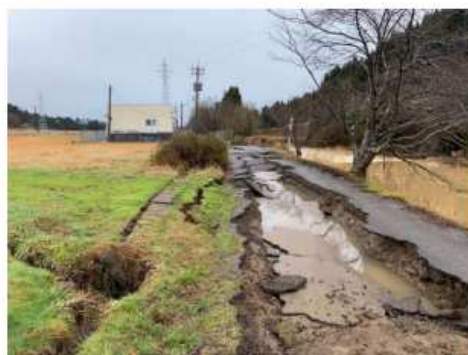
【被害状況】珠洲市宝立浄水場（導水管）
