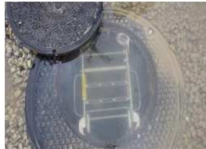
人孔内滞水(七尾市)
