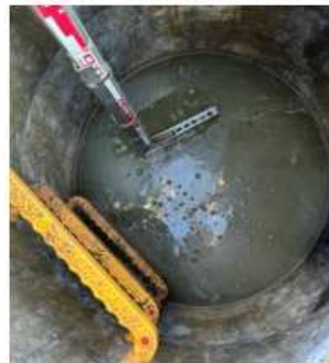
人孔内土砂閉塞(羽咋市)
