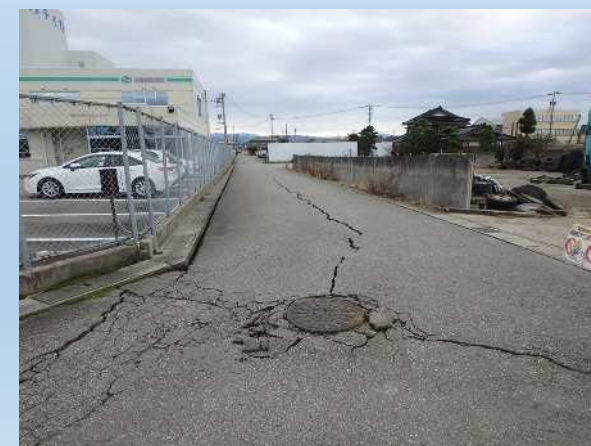
液状化による被害（管路・マンホール）
