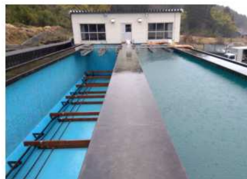
【被害状況】珠洲市宝立浄水場（沈殿池）
