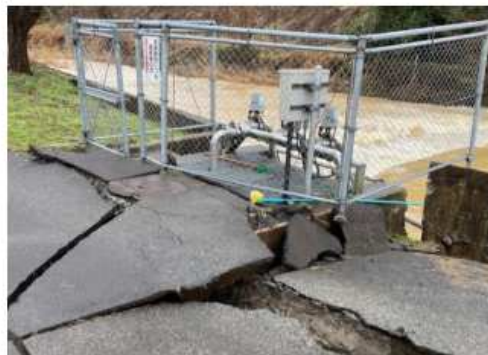
【被害状況】珠洲市宝立浄水場（取水口）
