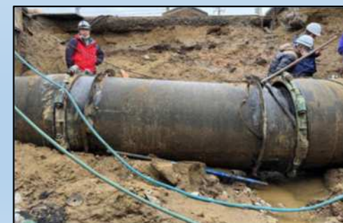
送水管の被災状況（七尾市）
