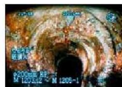
老朽化した下水管
