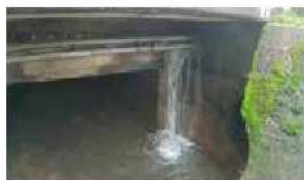
水道管からの漏水
