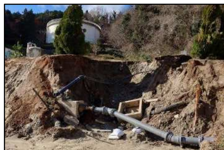
浄水場の被災状況(七尾市)
