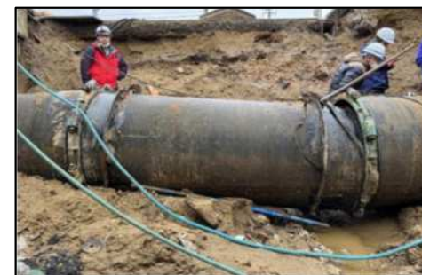
送水管の被災状況(七尾市)
