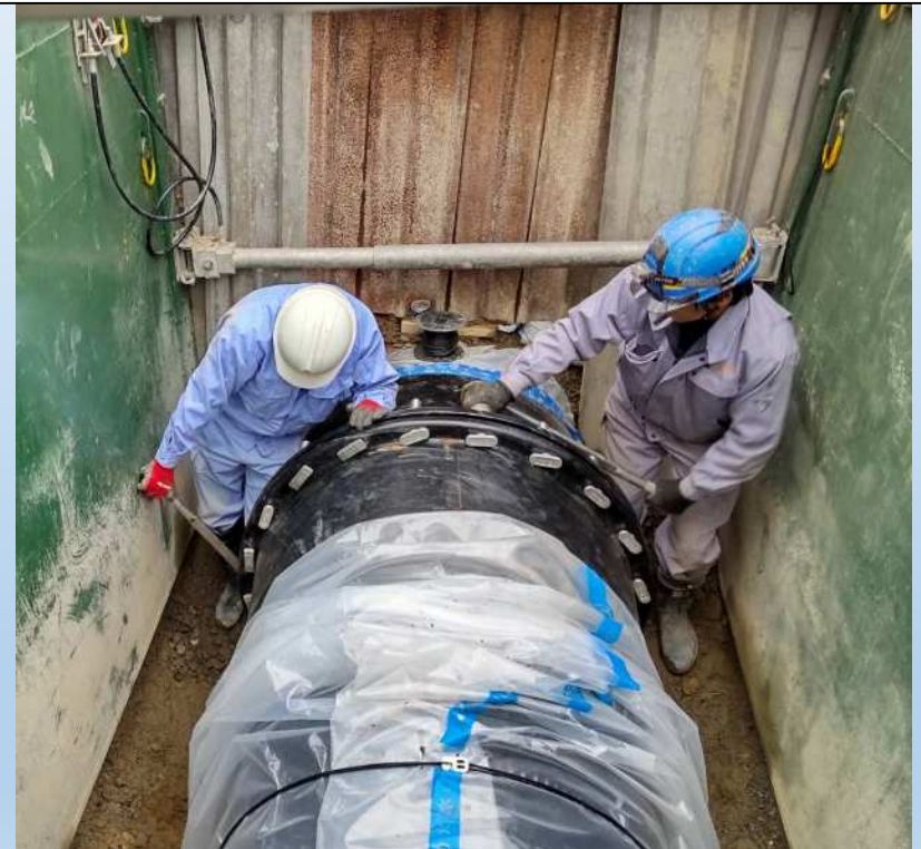
配水幹線（南部幹線、口径900mm）
