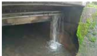
水道管からの漏水
