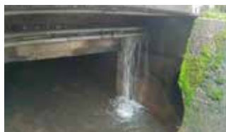
水道管からの漏水
