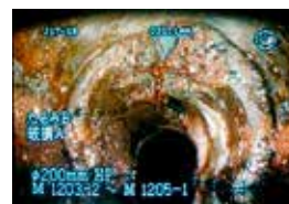
老朽化した下水管
