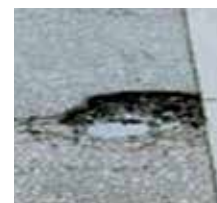
損傷の近くで撮影
