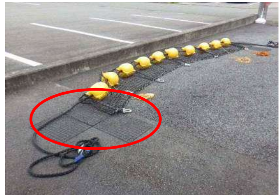
【すり抜け防止用フェンス】
