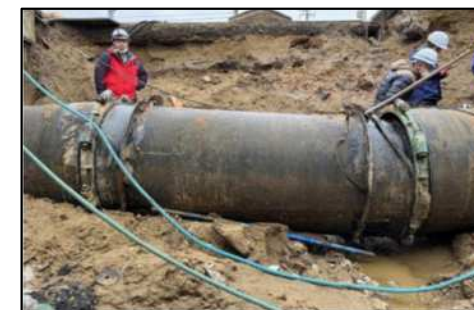
送水管の被災状況(七尾市)
