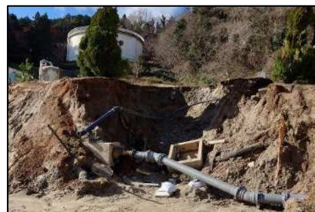
浄水場の被災状況(七尾市)
