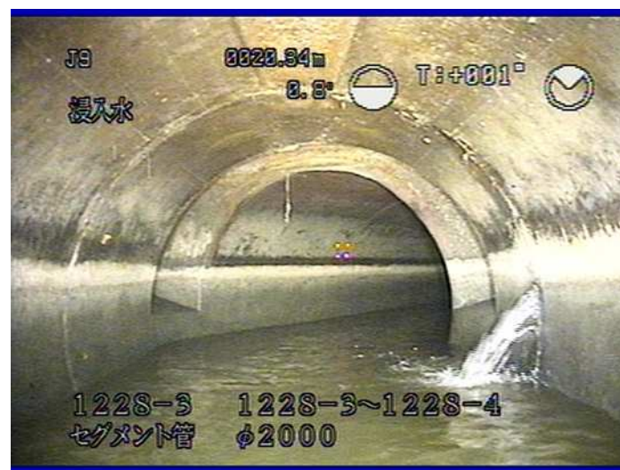
緊急度Ⅱ 侵入水の状況
