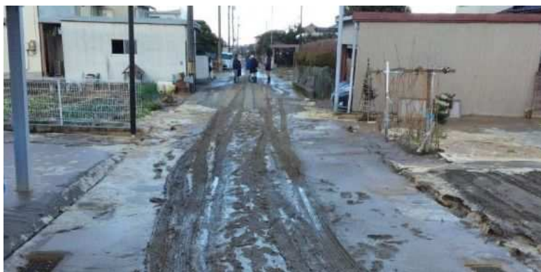
液状化した道路（蓮町五丁目地内）
