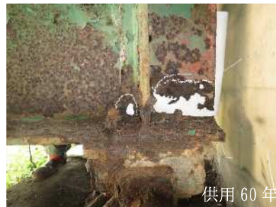
主桁の腐食・孔食
