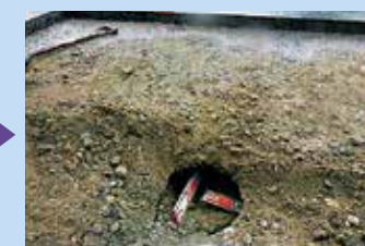
道路下の空洞
