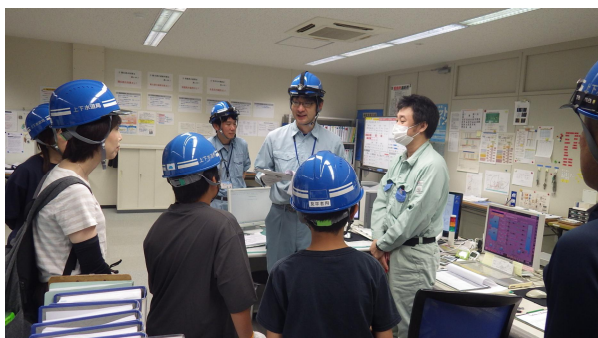
運転状況の監視を行う中央管理室での業務説明
