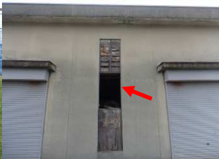
資材倉庫 扉破損
