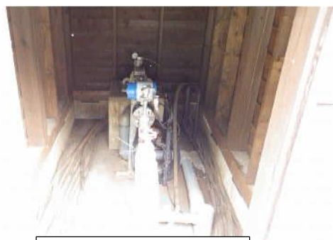
ポンプ設置部写真
