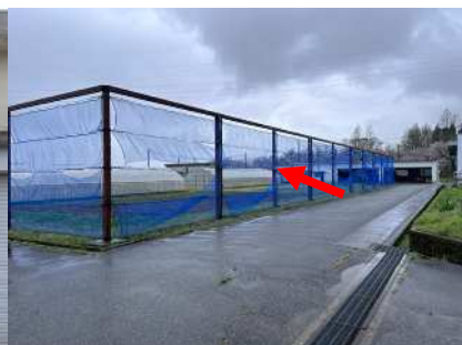
防風ネット破損状況
