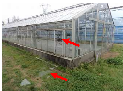
温室ガラス破損（一例）
