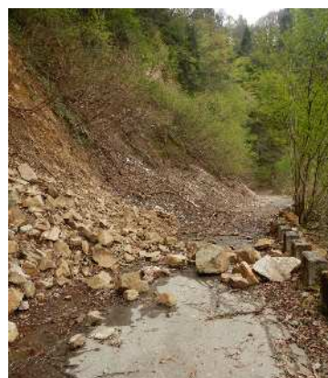
崩土除去（一覧表：細入 1）
