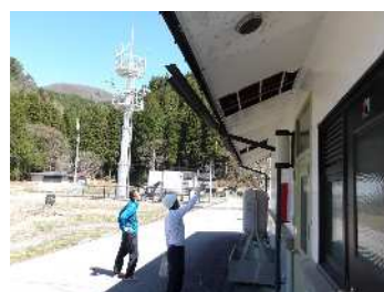
雨樋の破損状況
