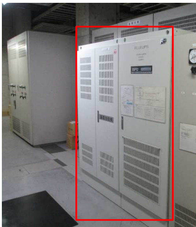
無停電電源装置全景
