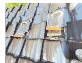
屋根瓦の破損状況
