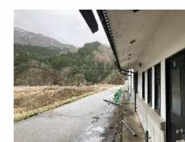
雨樋の破損状況
