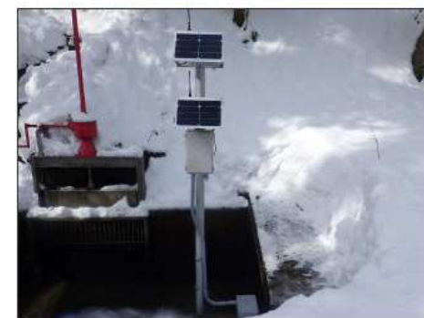
農業用水路に設置したIoT水位センサー
