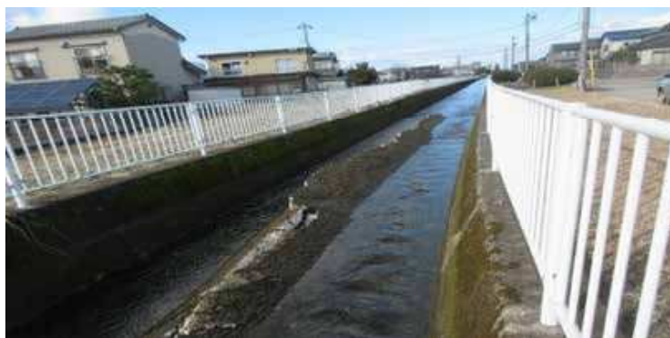
水路底が破損した農業用水路（上飯野地内）
