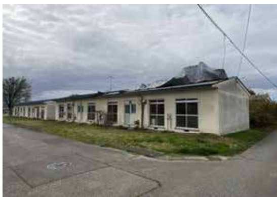
強風により被害を受けた老朽空き家 (令和8年4月)
