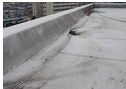
長寿命化による住環境確保が必要な例(屋上防水)
