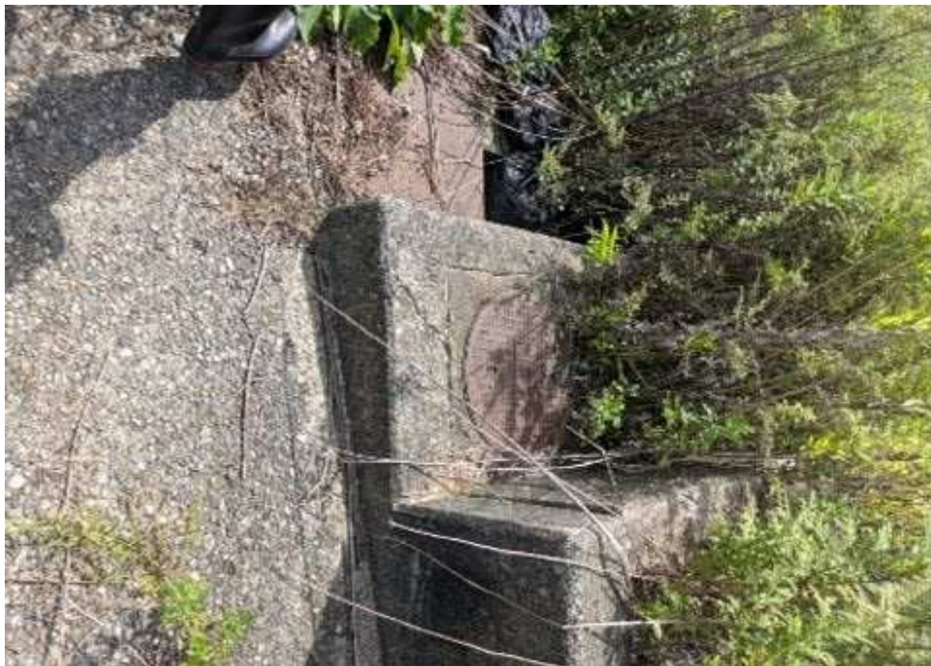
㊤水栓残置(令和8年9月撮影)※給水不可
