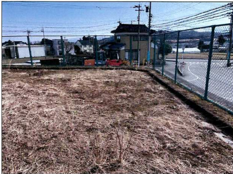
旧八尾中学校 閲覧資料7 17 グラウンド周囲の側溝 残置
