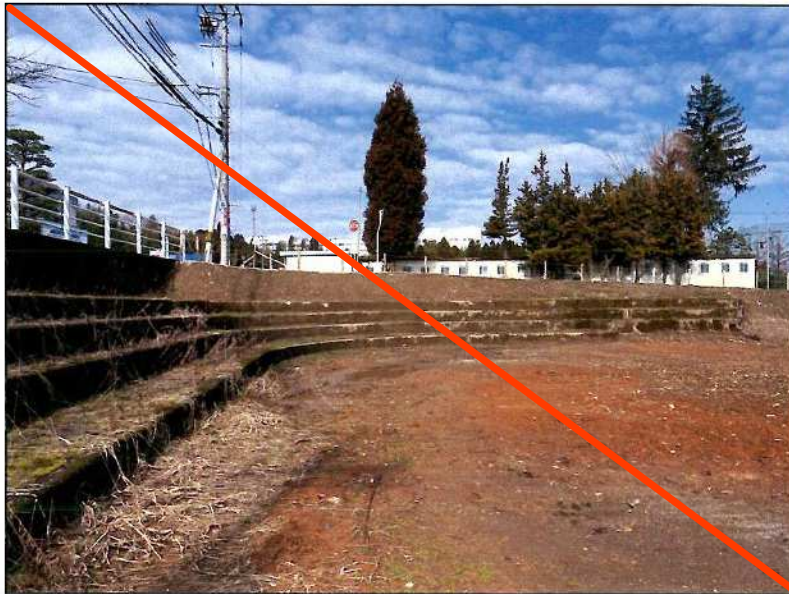
旧八尾中学校 閲覧資料7 7 相撲場観覧席の階段状コンクリート 残置
